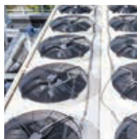
HVACシステム
